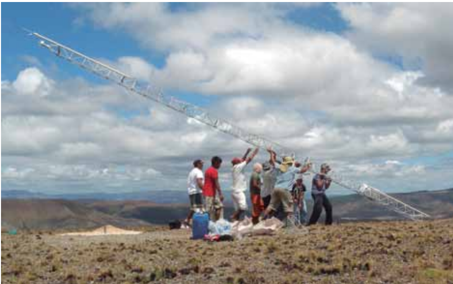
Instalação de torre para medição de vento na Serra do Tamanduá, TI Raposa Serra do Sol (RR). © ALDENIR CADETE/CIR
